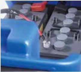
Batterien und Ladegeräte
